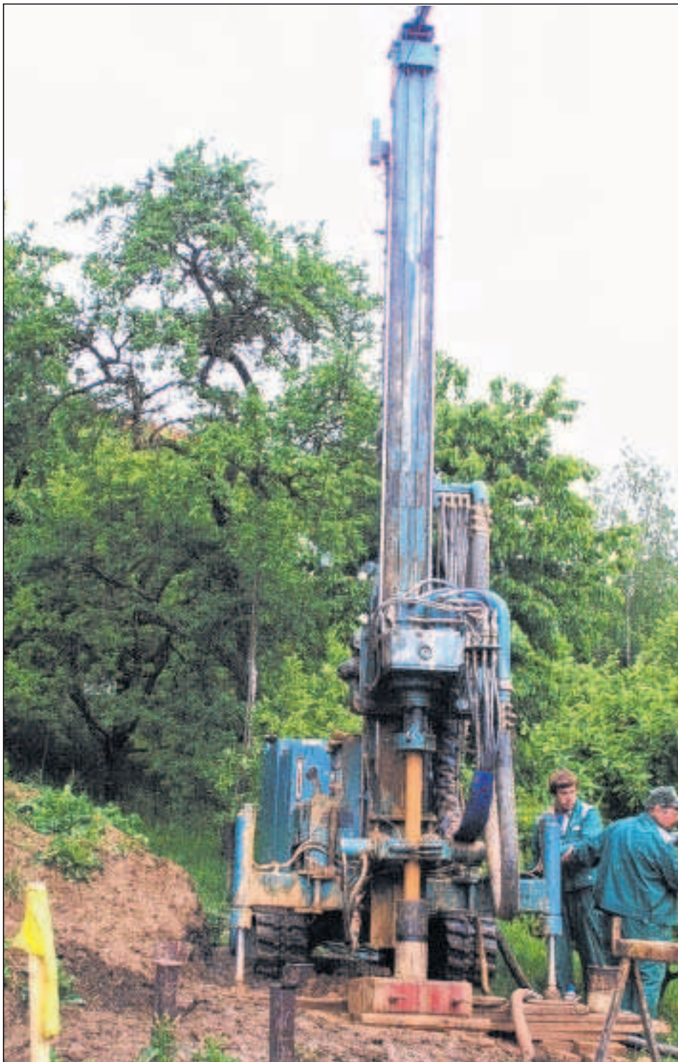
Eine Alternative zur Öl- oder Gasheizung ist neben der Solarenergie bei Einfamilienhäusern die Erdwärme. Am Wellenberg wird derzeit ein Neubau mit 140 Quadratmetern Wohnfläche nach diesem Prinzip für Heizung und Warmwasser ausgerichtet. Weitgehende Unabhängigkeit von fossilen Energien ist das Ziel. hvb/Bild: Heike v. Brandenstein
