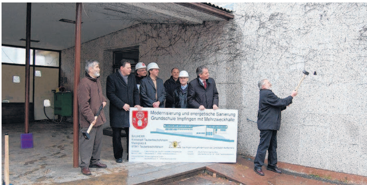
Die Generalsanierung der Grundschule Impffingen und der Halle hat begonnen. Mit kräftigen Schlägen hieb Ortsvorsteher Gottfried Wühr (rechts) gestern ein Loch in die Waschbetonfassade. Im Beisein von Bürgermeister Wolfgang Vockel, Stadtbaumeister Michael Knappe, Schulleiter Ulrich Karl, Architekt Frank Künzig sowie weiteren an Bau und Planung beteiligten gab Wühr damit den Startschuss für die rund 1,9 Millionen teure Maßnahme.
